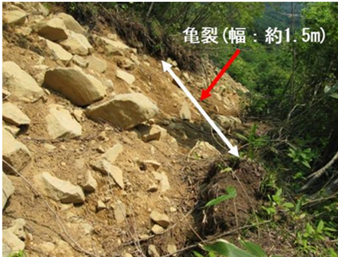
写真 崩壊斜面源頭部で確認した亀裂。2009年6月26日撮影。
